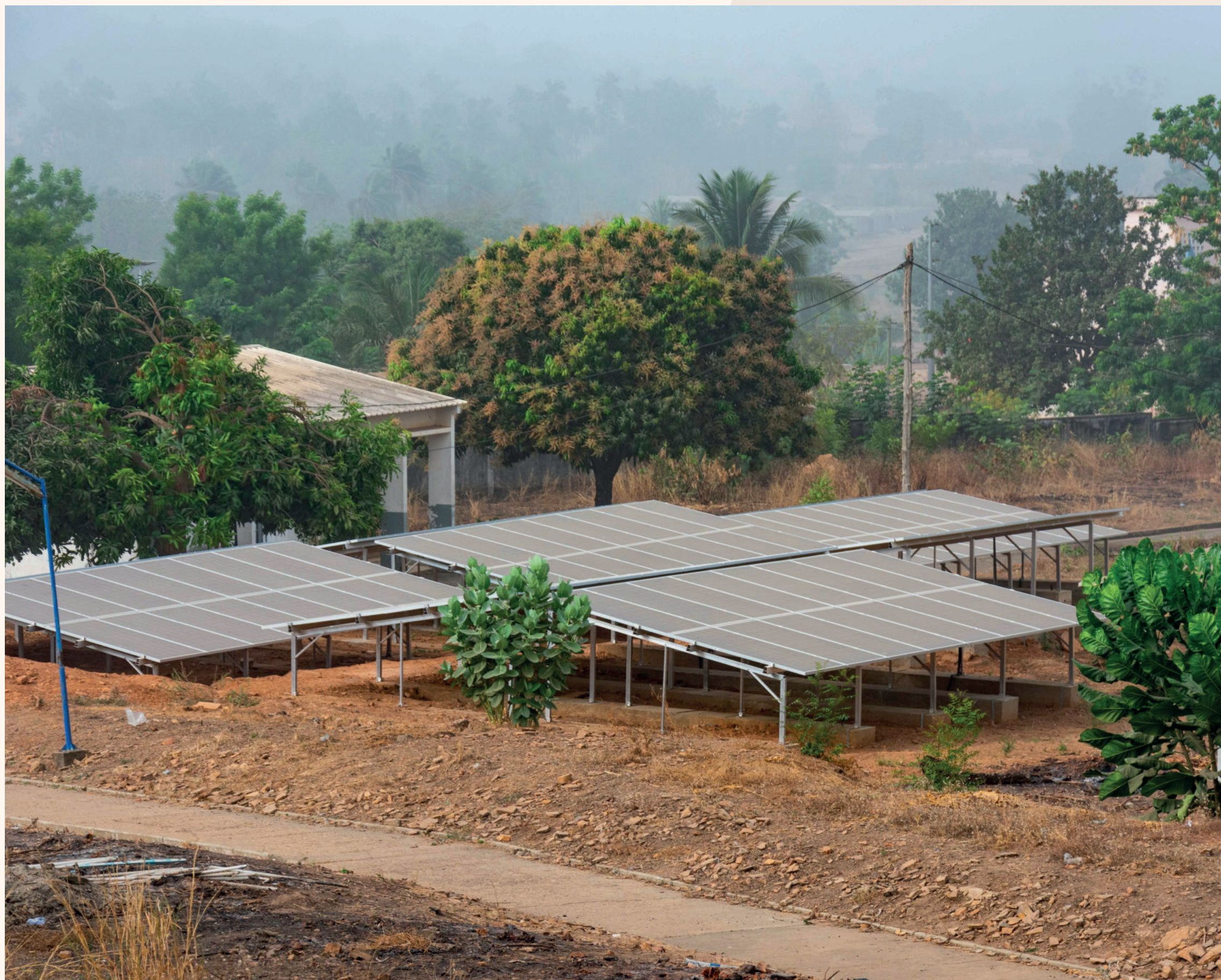
Die Solarpanels am Hospital von Sokodé/Tchaoudjo 1 – aus statischen Gründen neben dem Gebäudekomplex platziert. Copyright: Stadt Sokodé
